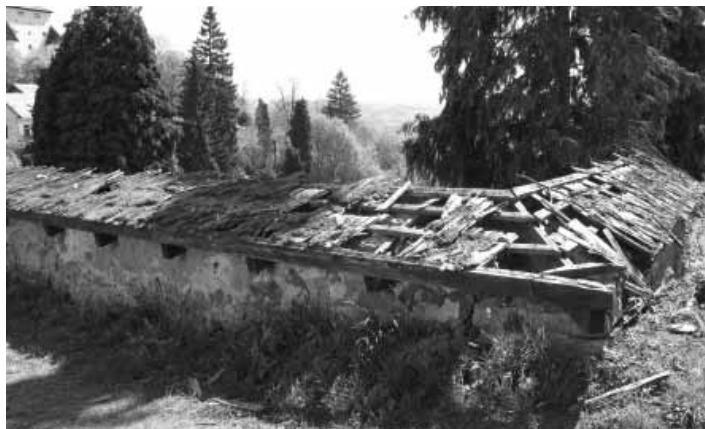
Havarijný stav ohradného múru FOTO FILIP GOLIAN
