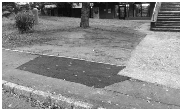
Odstránenie havarijného stavu FOTO MICHAL KRÍŽ
