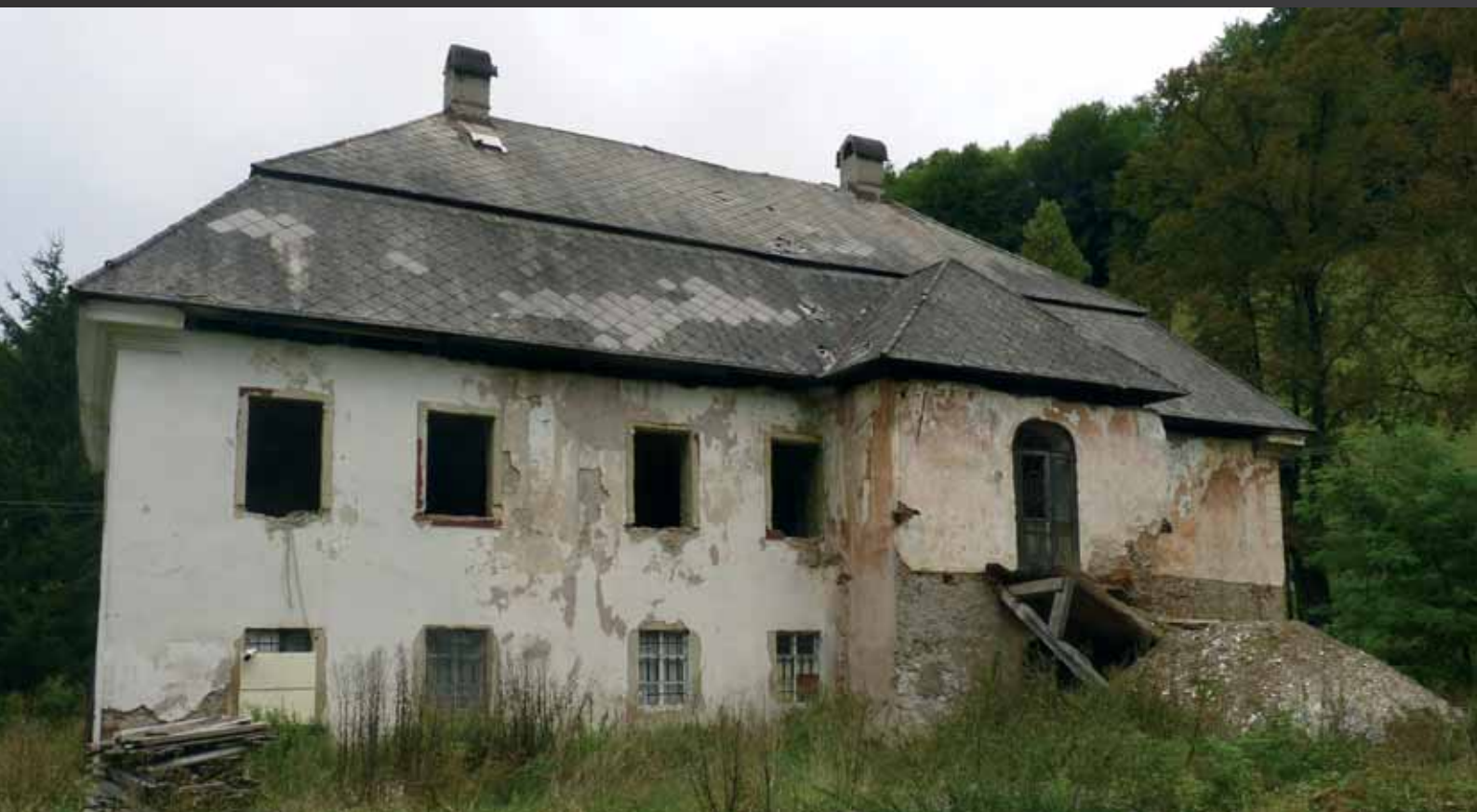
Vyhne, chátrajúci administratívny objekt
