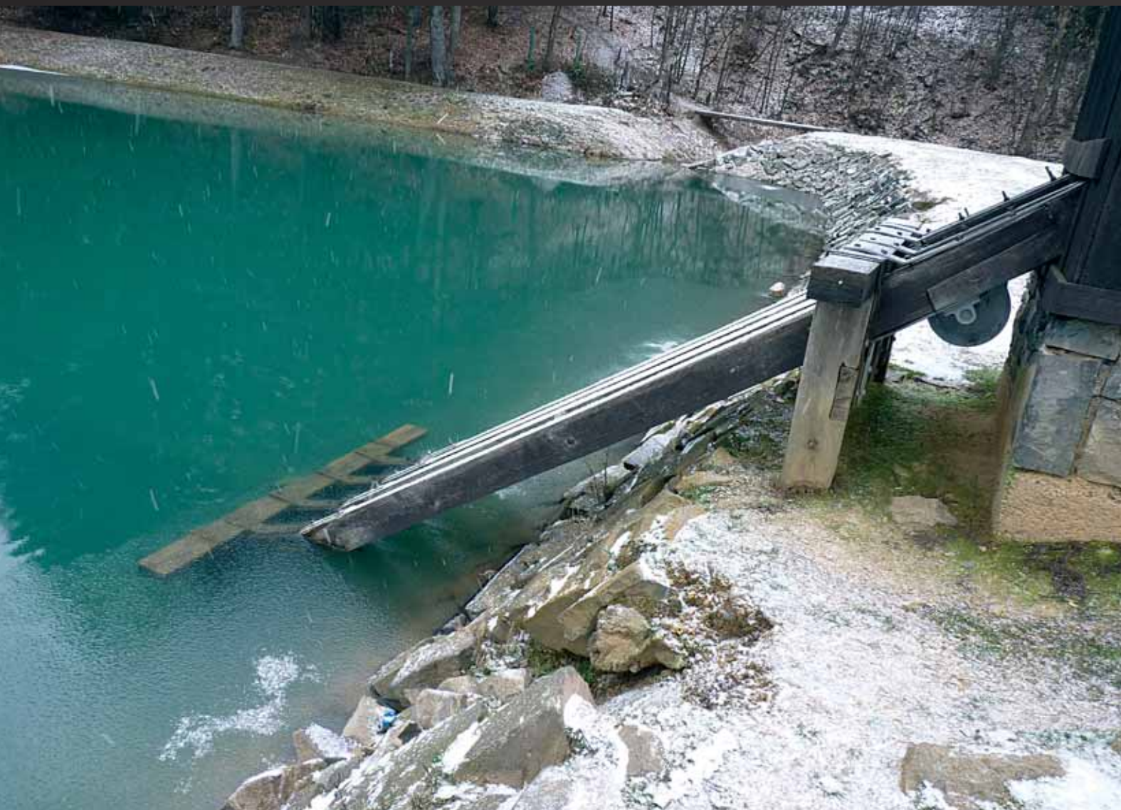
Banská Štiavnica, Veľká vodárenská nádrž, detail ovládacieho zariadenia
